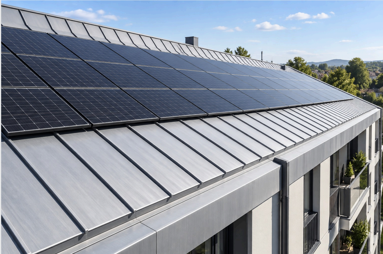
Photovoltaik auf einem Dach mit Stehfalzblech als Beispiel für das bauX-Dachkonzept.
